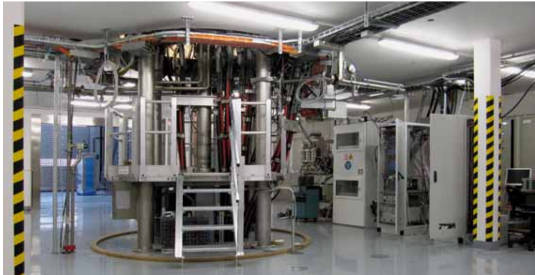
Защита серверов и кабельных каналов: XC10 обеспечивает комбинированное управление обнаружением возгораний и пожаротушением в Институте физики плазмы при Академии наук Чешской Республики.
